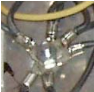
Un câblage de masse en étoile ...
